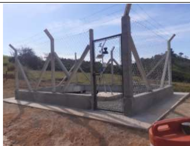
Foto 2 – Estação meteorológica automática instalada (Mai/2021).
